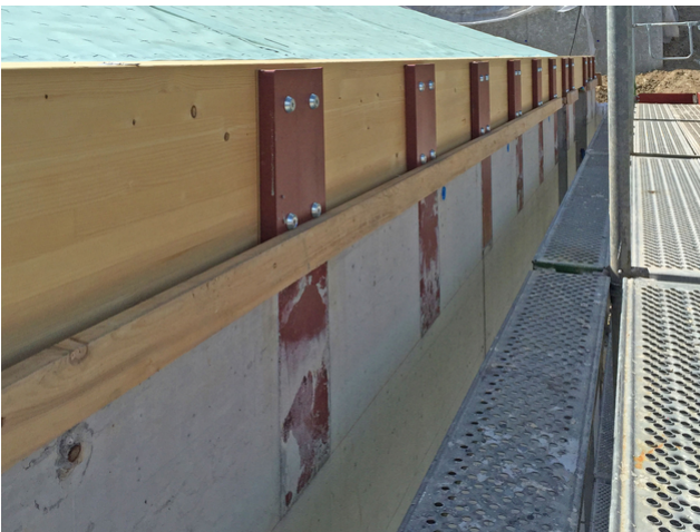
Nehmen die nach aussen wirkenden Horizontalkräfte auf: in den Beton eingelegte Stahlteile
