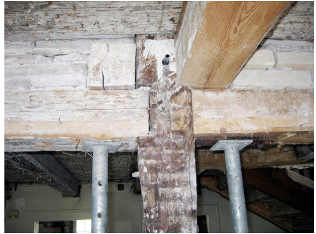
Unterstützung für Balken im Erdgeschoss vor der Sanierung
