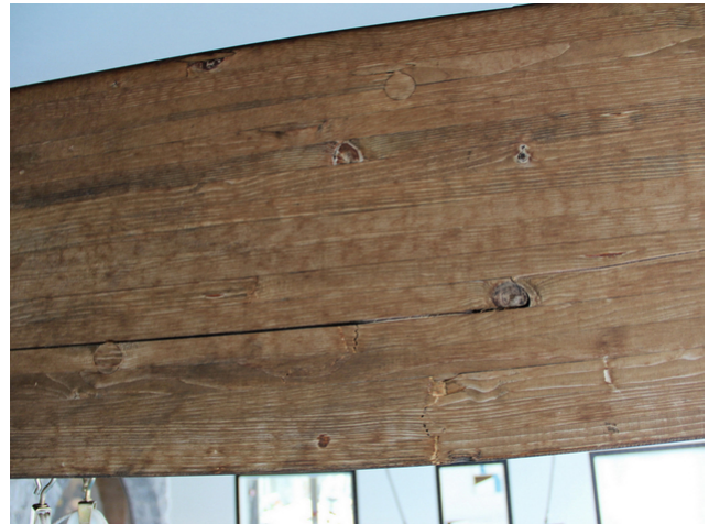
Versagen der Brettschichtholzträger
