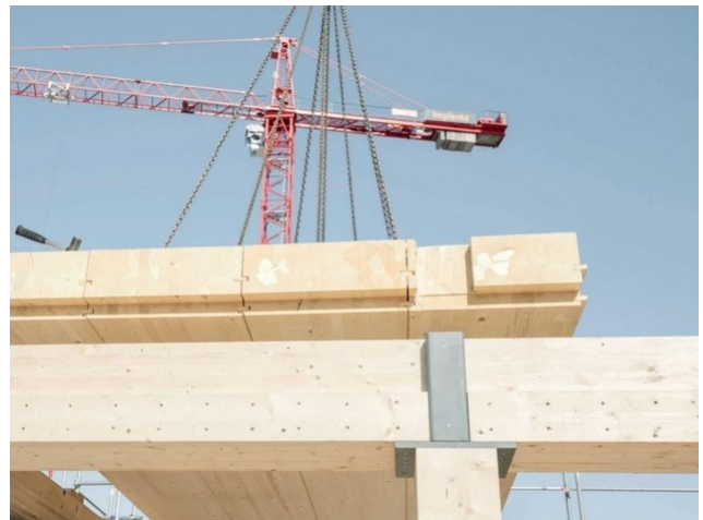
Der Knoten: Stahlteile leiten die Last von der einen Stützen zur nächste. Quelle: Hochparterre
