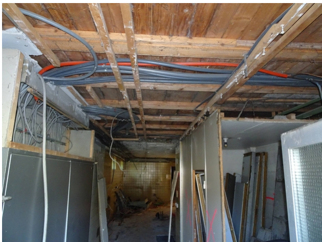
Decke vor der Ertüchtigung
