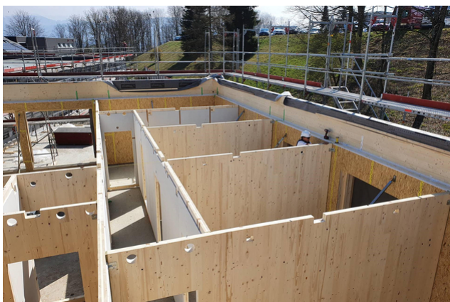
Murs intérieurs en bois lamellé-croisé
