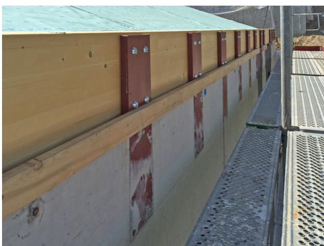
Absorbent les forces horizontales agissant vers l'extérieur : éléments en acier insérés dans le béton
