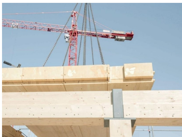
Le knot : des pièces d'acier transmettent la charge d'un pilier à l'autre. Source : Hochparterre
