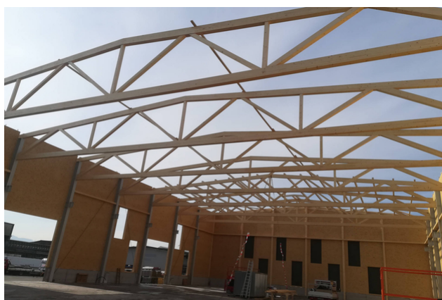
Montage hall de production
