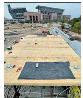
Aufsicht auf das Deckenfeld mit sechs „Spider-Connectoren“ im Abstand von 6,1 x 6,1 m. Die dazwischen liegenden Feldstreifen wurden mittels eingeklebten Stahlblechen eingehängt. Foto: Rothoblaas
