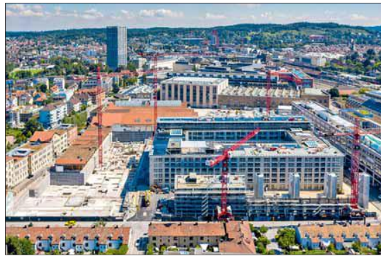
Das neue Quartier „Lokstadt“ in Winterthur entsteht auf dem ehemaligen Sulzerareal Werk 1 nahe dem Bahnhof. Wo früher Lokomotiven gebaut wurden, zieht neues Leben ein. Der 106 x 65 m im Grundriss messende Komplex bietet Raum für rund 250 Wohnungen. Fotos: Alessandro Della Bella (4)
