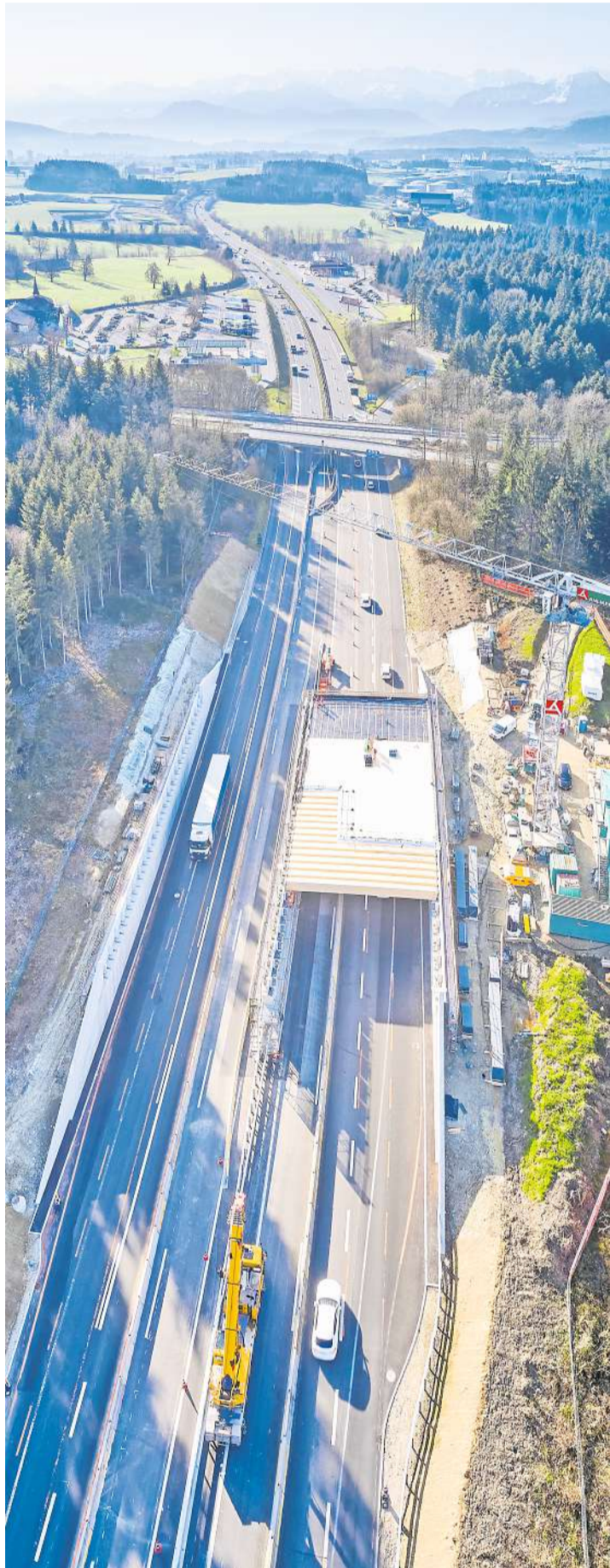
Die Träger der Wildtierbrücke Neuenkirch über die Fahrbahn der A2 in Richtung Gotthard werden eingesetzt. Bild: Astra
